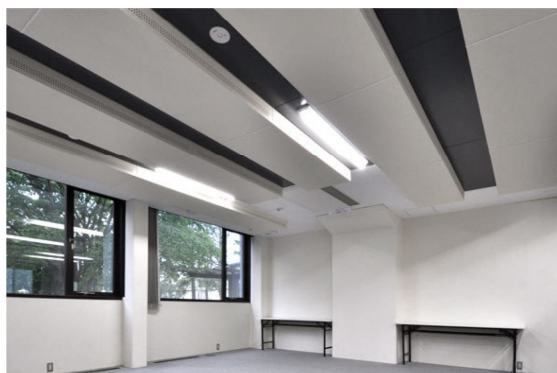
「R Air-con」を導入したオフィスの様子
